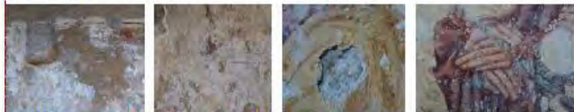
Detalles de los desperfectos en las pinturas murales (2008)
